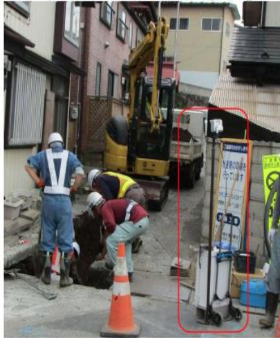
【モニタリングシステム設置状況】
