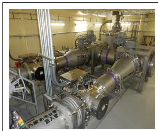
紫外線処理設備
