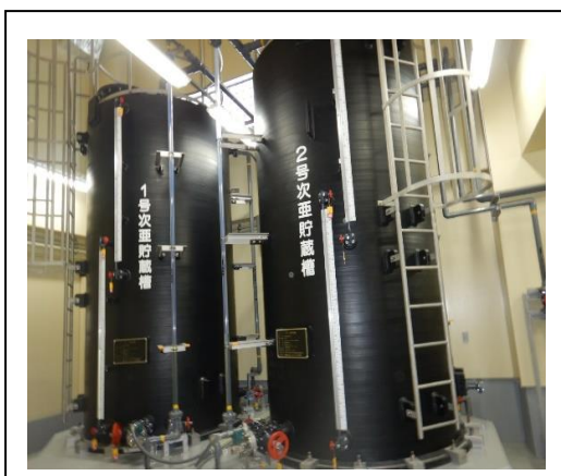
次亜貯留タンク
