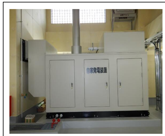
非常用発電設備
