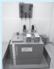
△次亜塩素酸ナトリウムを注入し塩素消毒をします。
