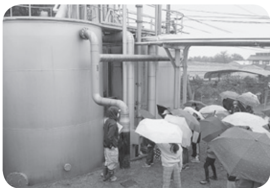
▲ろ過機について話を聞く様子 御代田浄水場にはろ過機が3台あり 現在2台が稼働しています
